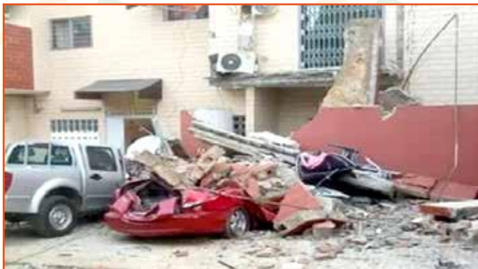
Le détachement de 3 balcons de la façade d'un immeuble, à la Riviera Bonoumin (Cocody) a causé d'importants dommages matériels.
