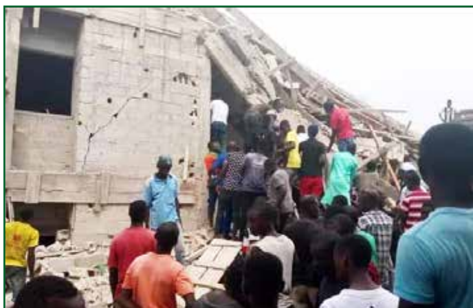
Des populations sur les décombres d'un immeuble en construction à Anono, dans la commune de Cocody pour secourir des victimes.
