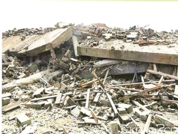
Débris d'un immeuble en construction écroulé à Cocody Angré le 19 mai 2019.
